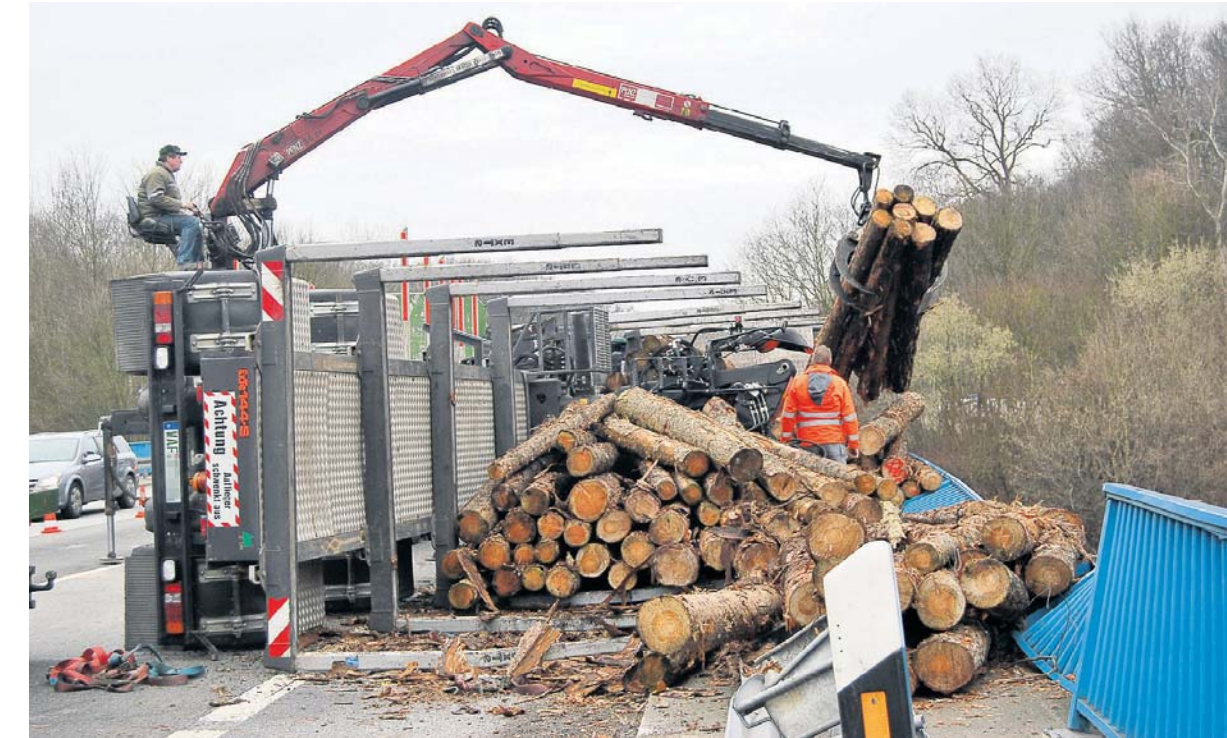
Vorsichtig barg ein Kran die Baumstämme des umkippten Lkw. Dabei konnte nicht verhindert werden, dass weitere Stämme über das beschädigte Geländer von der Brücke auf die gesperrte Autobahn fielen.
