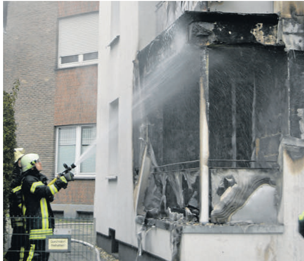
Nicht mehr bewohnbar ist nach dem Brand gestern Morgen die Wohnung im Mehrfamilienhaus an der Friedrich-Ruin-Straße.
